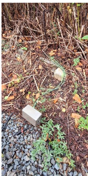
Figure 6 : photographie d'un câble électrique dissimulé par la végétation
